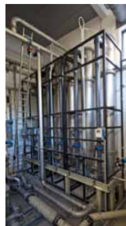
Advanced treatment technology in Gelsenkirchen (D)
